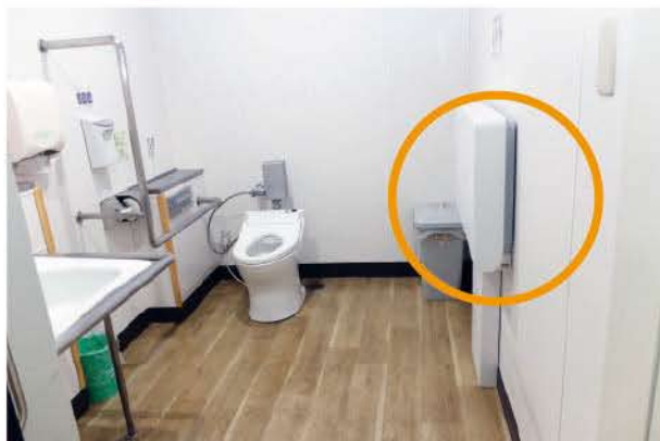
売店前にある車椅子用トイレ （ベビーシートを折りたたんだ状態）
