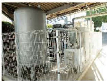
井水プラントの設備
